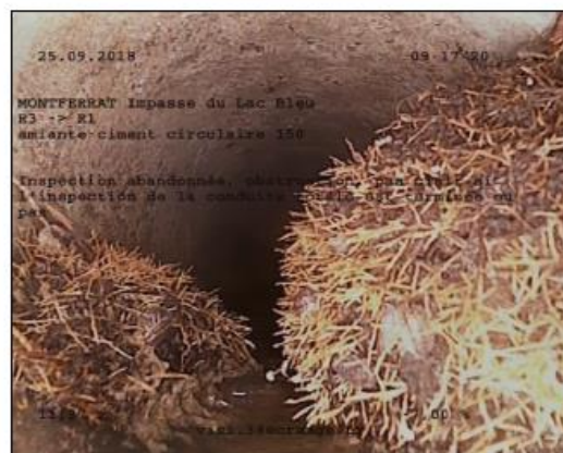
Photo: 3_8A 11,37m, Inspection abandonnée, obstruction, pas clair si l'inspection de la conduite totale est terminée ou pas
