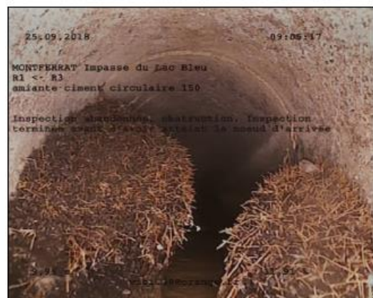
Photo: 2_5A 10,09m, Inspection abandonnée, obstruction. Inspection terminée avant d'avoir atteint le noeud d'arrivée
