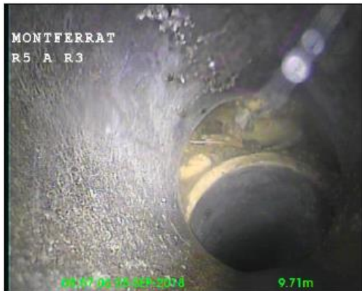
Photo: 7_7A 9,75m, Déplacement d'assemblage, radial à 6 h. -
