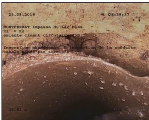
Photo: 1_8A 25,81m, Inspection abandonnée. L'inspection de la conduite totale n'est pas terminée
