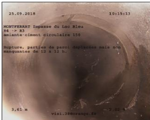
Photo: 8_2A 3,61m, Rupture, parties de paroi déplacées mais non manquantes de 12 à 12 h. -
