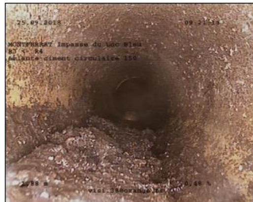
Photo: 4_2B 1,4m, Dépôts de matériau fin (sable, vase) sur le radier de 4 à 8 h. -
