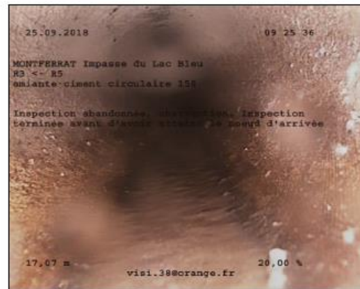
Photo: 5_7A 17,07m, Inspection abandonnée, obstruction. Inspection terminée avant d'avoir atteint le noeud d'arrivée
