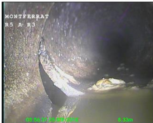
Photo: 7_4A 8,33m, Déplacement d'assemblage, radial à 12 h. -
