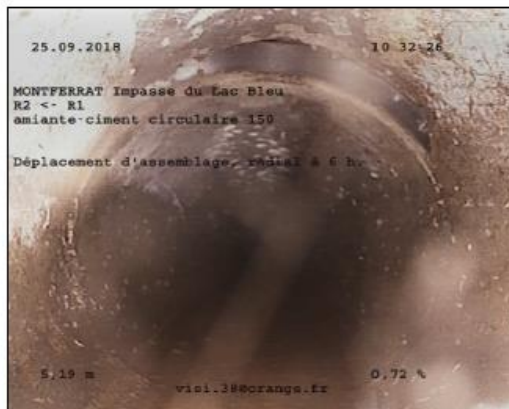
Photo: 9_2A 5,19m, Déplacement d'assemblage, radial à 6 h. -
