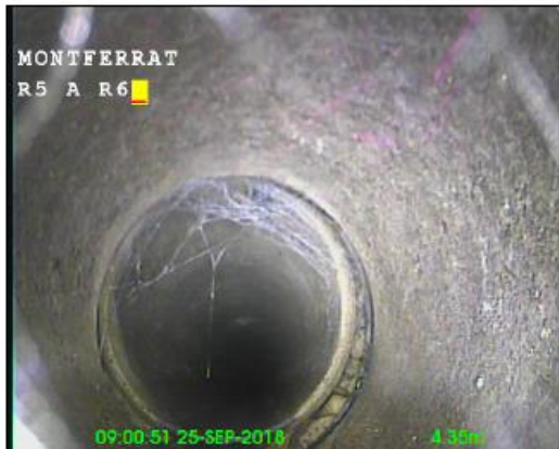
Photo: 7_2A 4,35m, Déplacement d'assemblage, radial à 12 h. -
