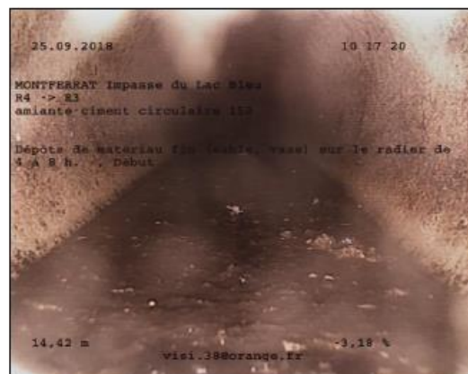
Photo: 8_4A 14,42m, Dépôts de matériau fin (sable, vase) sur le radier de 4 à 8 h. -, Début
