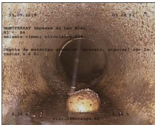
Photo: 4_3A 2,3m, Dépôts de matériau grossier (gravats, gravier) sur le radier à 6 h. -
