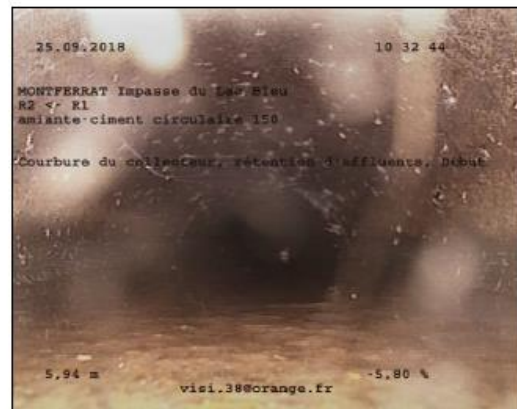
Photo: 9_3A 5,94m, Courbure du collecteur, rétention d'effluents, Début
