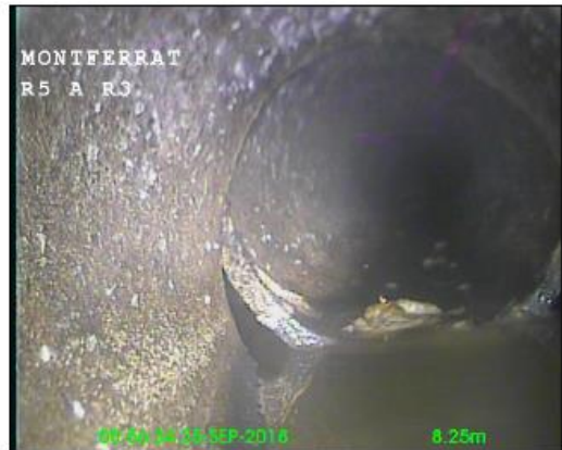
Photo: 7_3A 8,33m, Rupture, parties de paroi déplacées mais manquantes de 12 à 12 h. -
