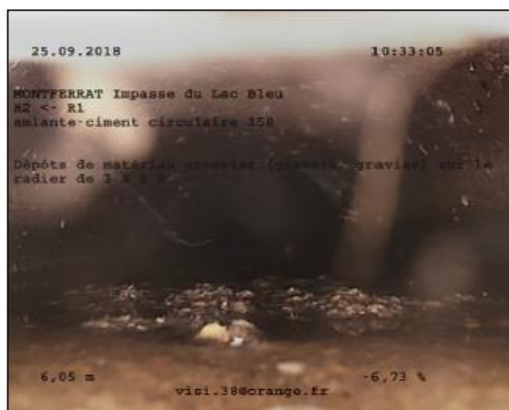
Photo: 9_4A 6,05m, Dépôts de matériel grossier (gravats, gravier) sur le radier de 3 à 9 h. -
