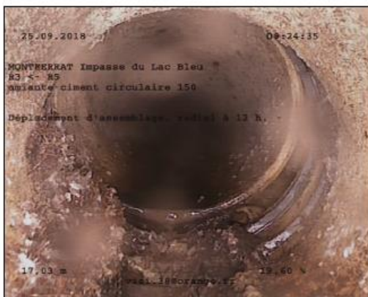
Photo: 5_4A 17,07m, Déplacement d'assemblage, radial à 12 h. -
