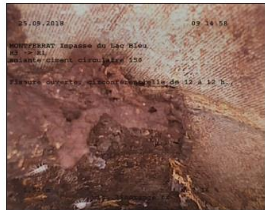
Photo: 3_3A 1,52m, Fissure ouverte, circonferentielle de 12 à 12 h., -
