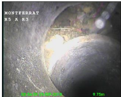
Photo: 7_6A 9,75m, Rupture, parties de paroi déplacées mais manquantes de 12 à 12 h. -
